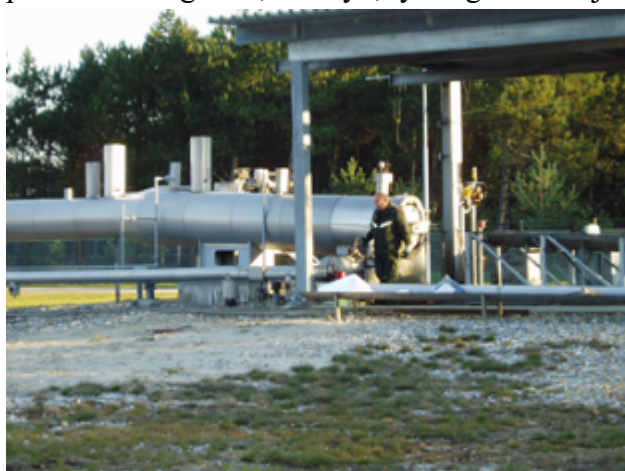
Figur 5. ”Grisesluse” til modtagelse af grise. Danish Oil Pipe’s olierørledning (Filsø).
