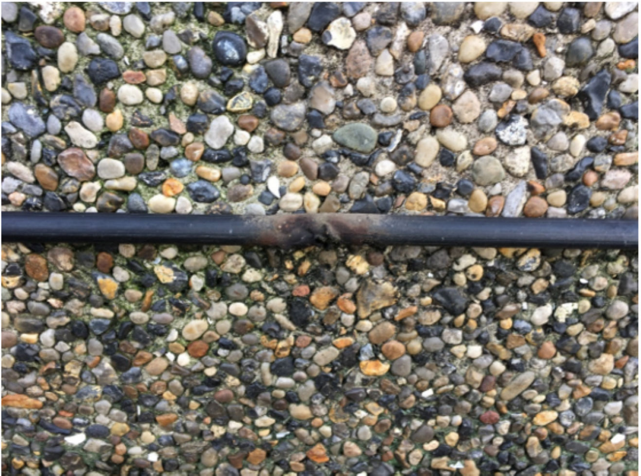
Foto 3. Eksempel på skade på kabelbeskyttelse.
