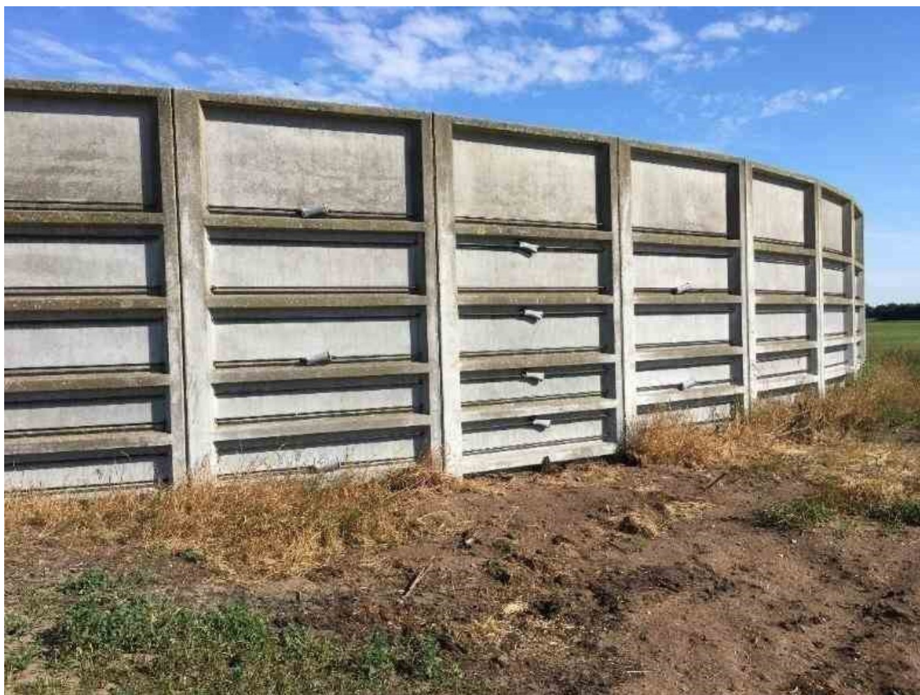
Foto 5: Perstrup beholder med udvendige kabler og dywidag-samlinger.
