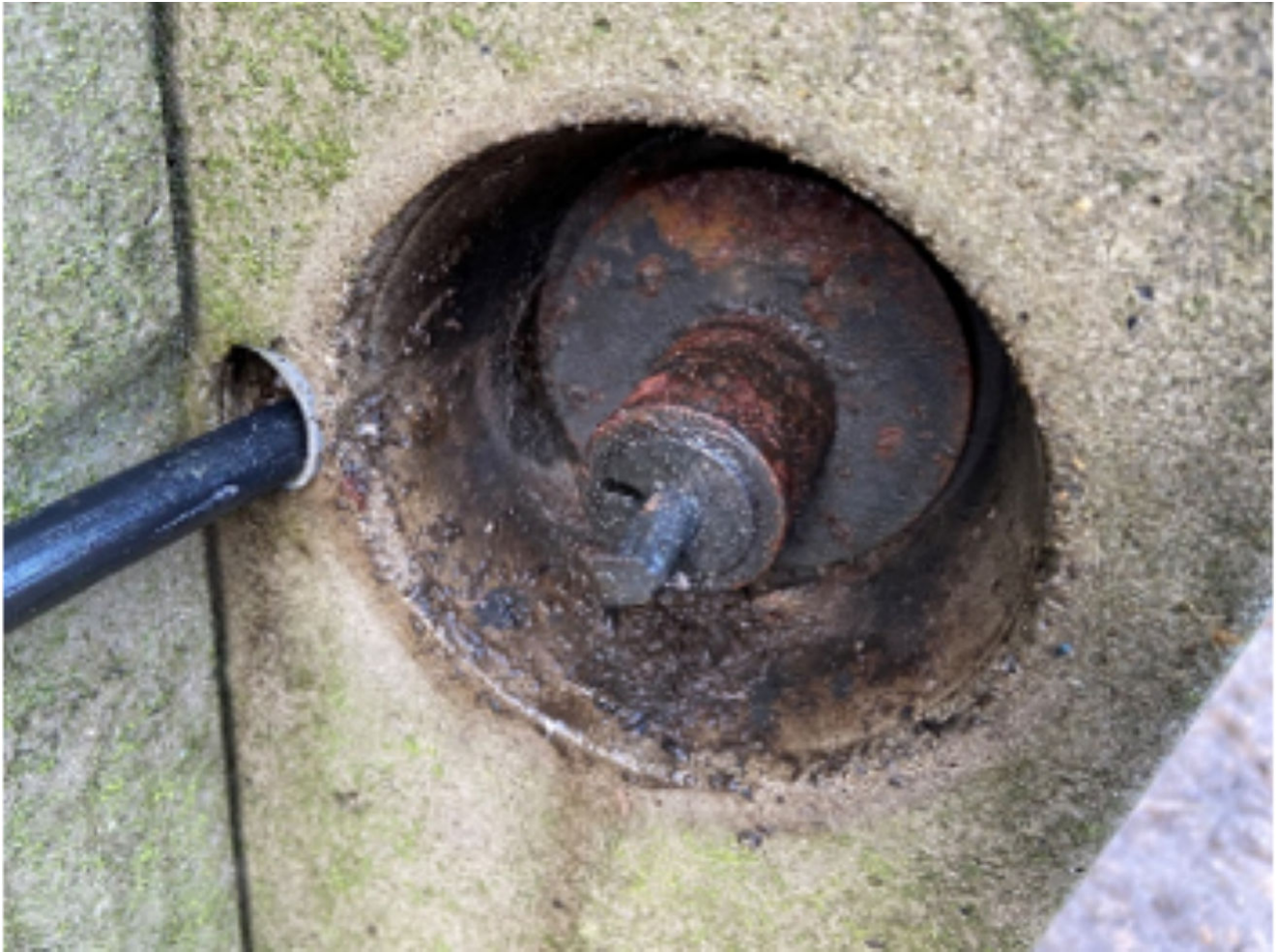
Foto 3. Korrosion på ståldele
