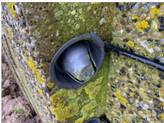
Foto 32. Beskadiget afdækningshætte på Muleby beholder.
