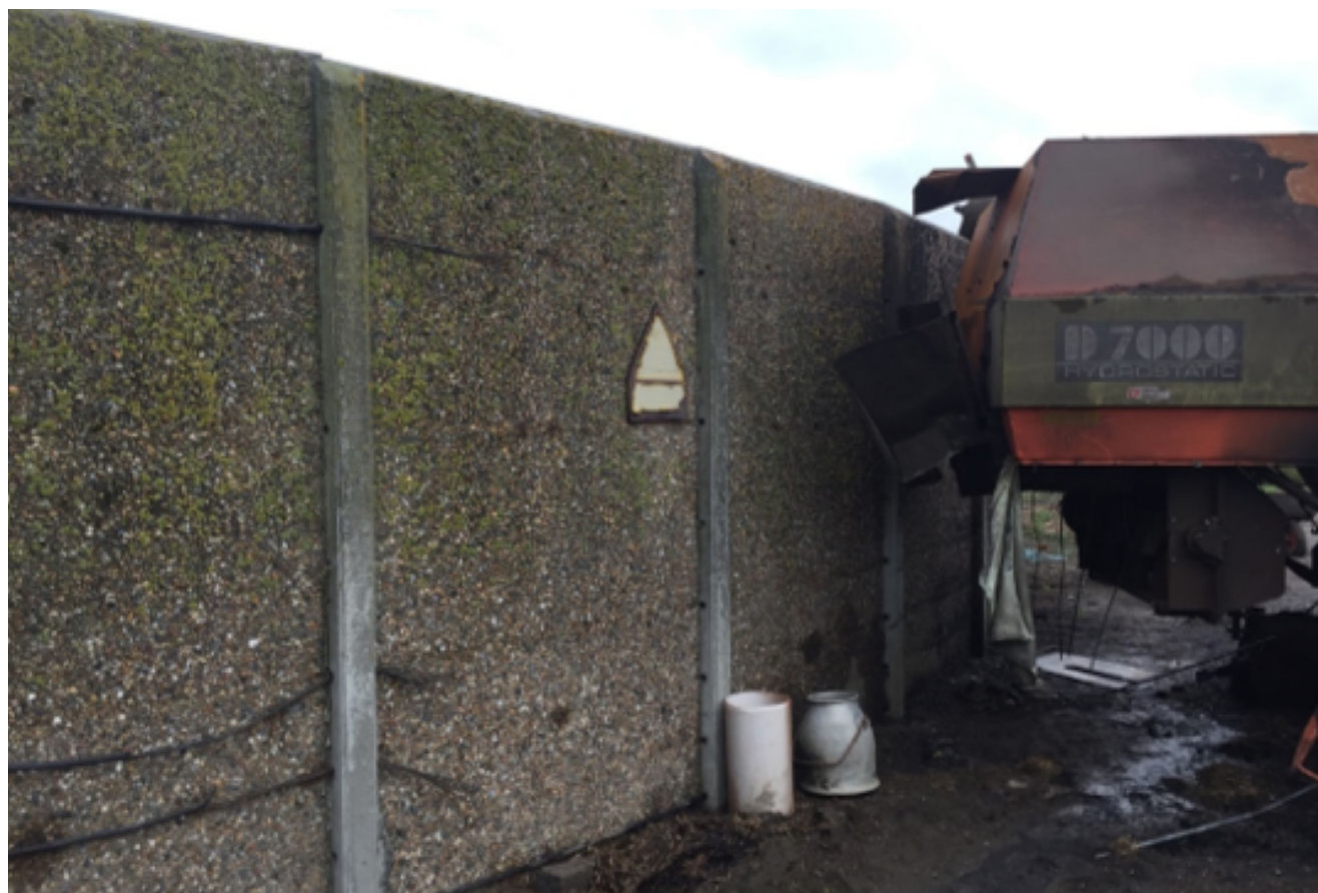
Foto 1. Omfattende skader på kabler efter brand.
