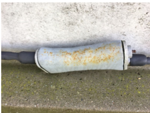
Foto 21. Mindre grad af overfladerust på låsens overfladebehandling.
