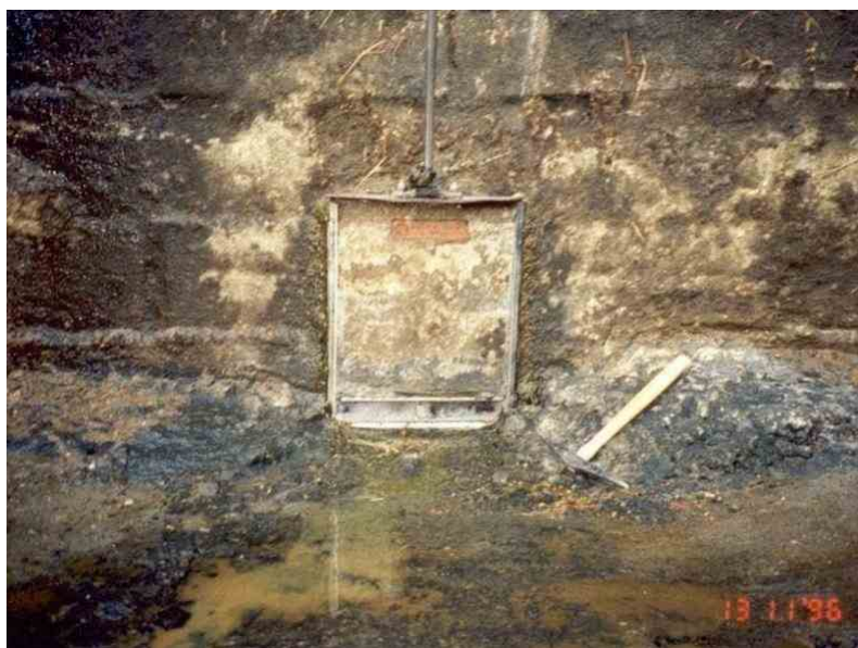
Foto 54: Beholdere med spjæld, se vejledning afsnit 3.4.
