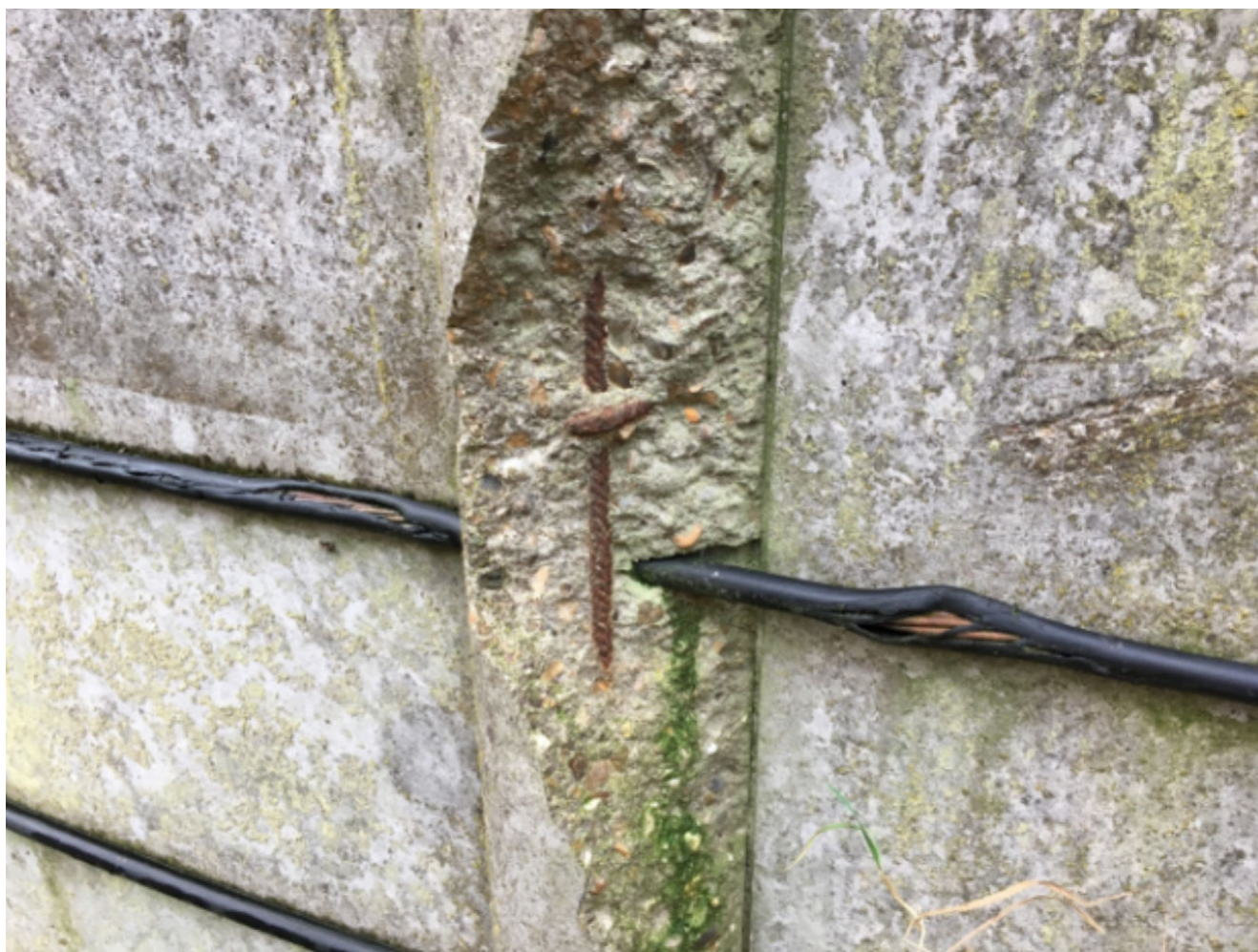
Foto 2. Større skader på kabelbeskyttelsen efter påkørsel.
